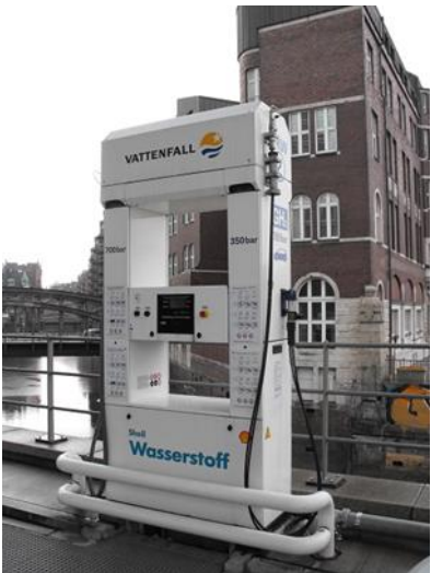
Figure 36: Dispenser 350 bar (Vattenfall Hamburg)
