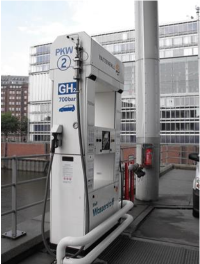
Figure 35 : Dispenser 700 bar (Vattenfall-Hamburg)
